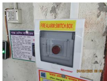
Fire Alarm Switch.JPG
